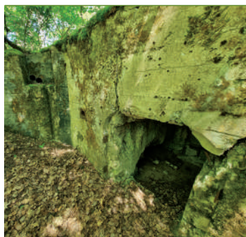
Schron Br.7; po lewej wnęka do montażu urządzenia do łączności optycznej; fot. Jarostaw Leszczetowski
