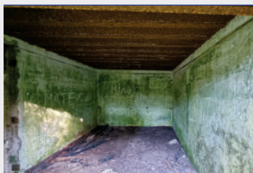
Pomieszczenie garażowe w schronie T.2; fot. Jarostaw Leszczetowski
