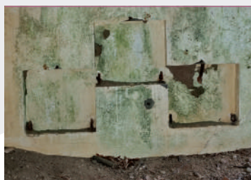
Schron bojowy B.23; nisze na rozkładane siedziska i stolik; fot. Jarosław Leszczetowski
