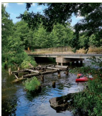
Most betonowy i ruiny starego drewnianego na zachód od dawnej wsi Dydulany; fot. Jarostaw Leszczetowski
