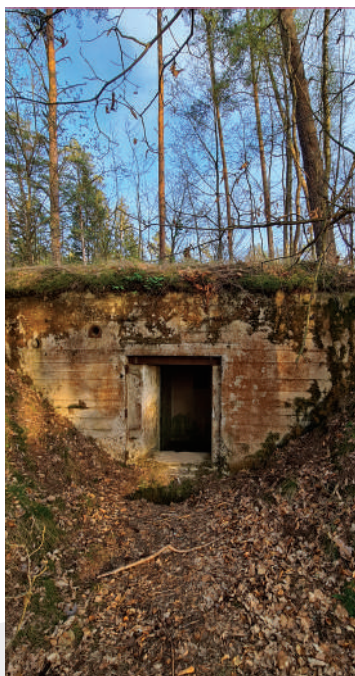
Pomalowana na brązowy maskujący kolor elewacja wejściowa schronu De.17; fot. Jarosław Leszczeński
