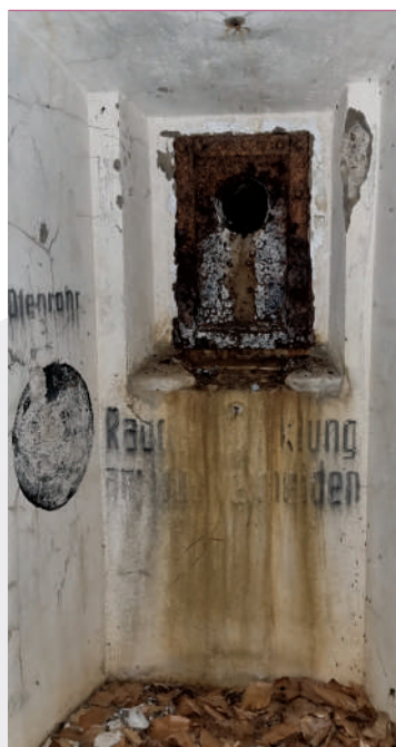
Miejsce na piecyk w schronie Karz.18 z opisem rury piecowej i okręgiem oznaczającym miejsce na fajerki; fot. Jarosław Leszczetowski;
