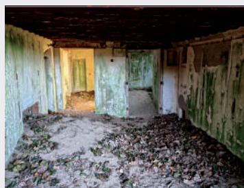
Większa izba bojowa w schronie Karz.14; po lewej drzwi do przedsionka; po prawej do mniejszej izby bojowej; fot. Jarosław Leszczetowski
