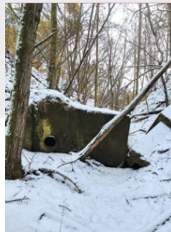
Ruiny budowli hydrotechnicznej w wąwozie; fot. Jarosław Leszczeński
