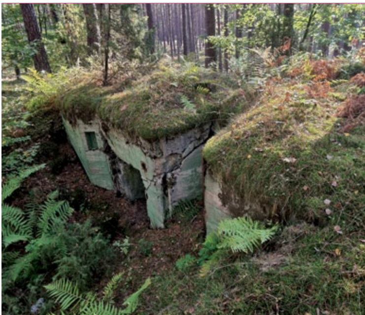
Elewacja wejściowa schronu Strau.W.4 ; po prawej widoczne stanowisko obserwatora; obok wejście i po lewej nisza wyprowadzenia linii telefonicznej; fot. Jarosław Leszczetowski
