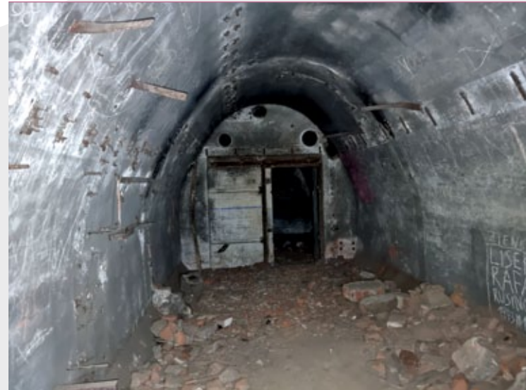
Pomieszczenia węzła łączności; fot. Jarosław Leszczełowski
