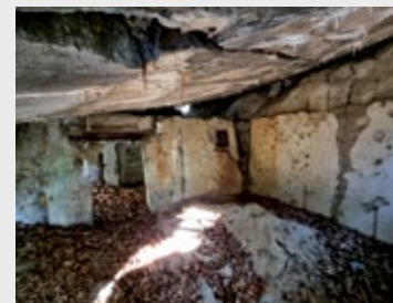
Schron Zie.6; pomieszczenie pogotowia i drzwi do przedsionka-słuzы gazowej; fot. Jarosław Leszczelewski
