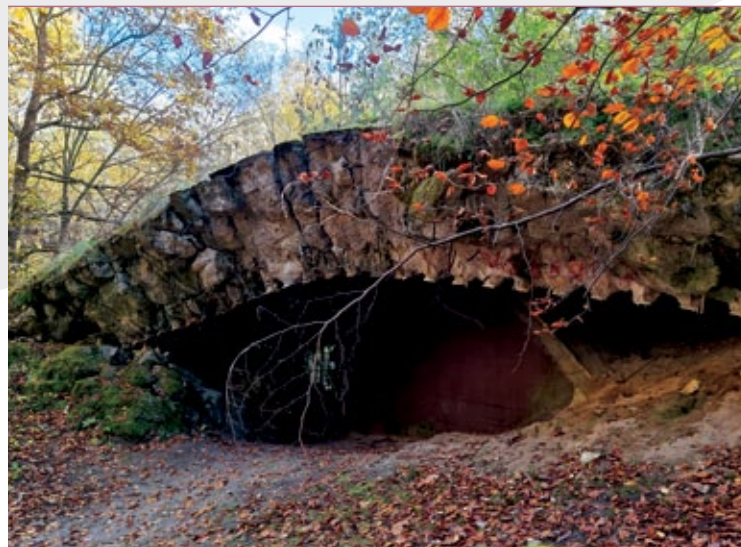
Wybrzuszony w wyniku wysadzenia strop bloku wejściowego A; fot. Jarosław Leszczyński
