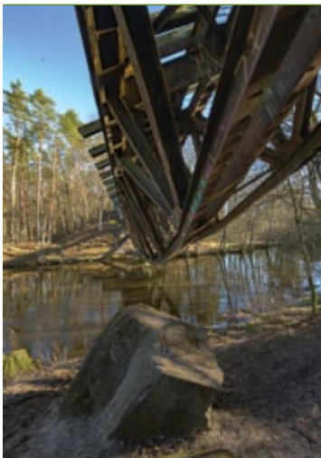
Zniszczony most kolejowy na Gwdzie; w tym miejscu walczyli żołnierze 8 Pułku Piechoty; fot. Maciek Leszczyński
