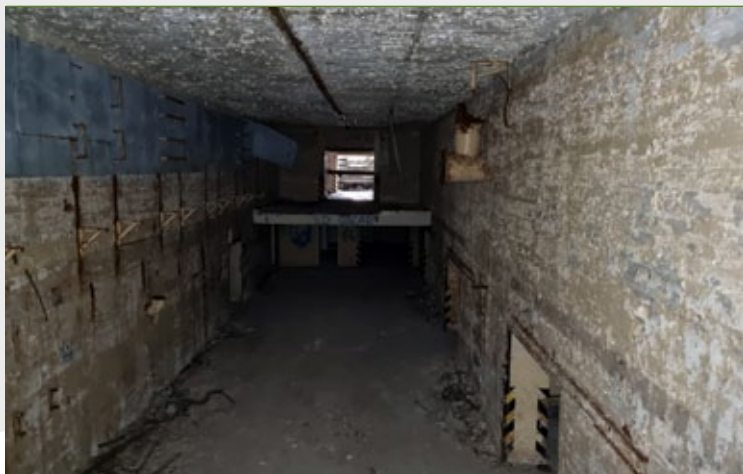
Hala obsługowa schronu T-7; po prawej widoczne bramy do magazynów głowic atomowych, po lewej wejście do kompleksu techniczno-socjalnego; fot. Jarosław Leszczetowski
